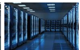
模組化資料中心為河南電信業者打造 IDC 機房
