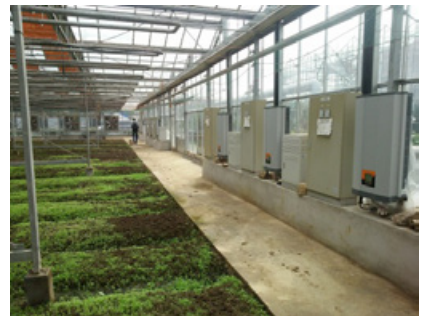
台达光伏逆变器打造2MW农业大棚
