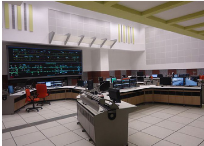
台达电视墙装置于孟买地铁站行控中心
