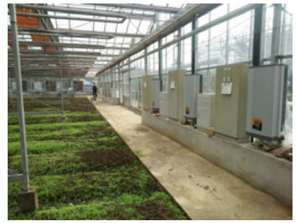
台達太陽能逆變器打造2MW農業大棚
