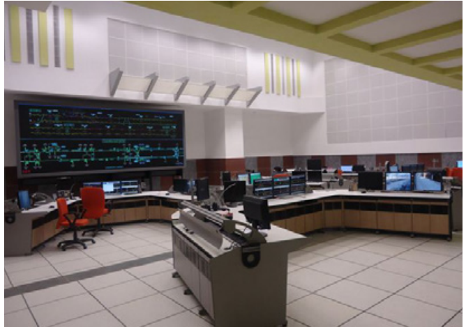
台達電視牆裝置於孟買地鐵站行控中心
